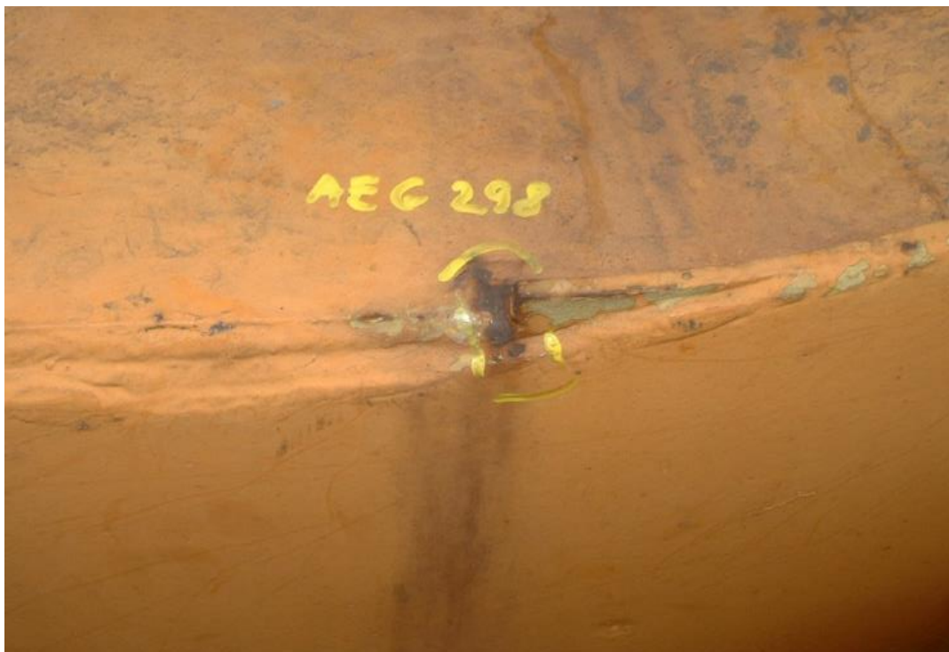
Varratból induló repedés a járműdaru gémtőnél
