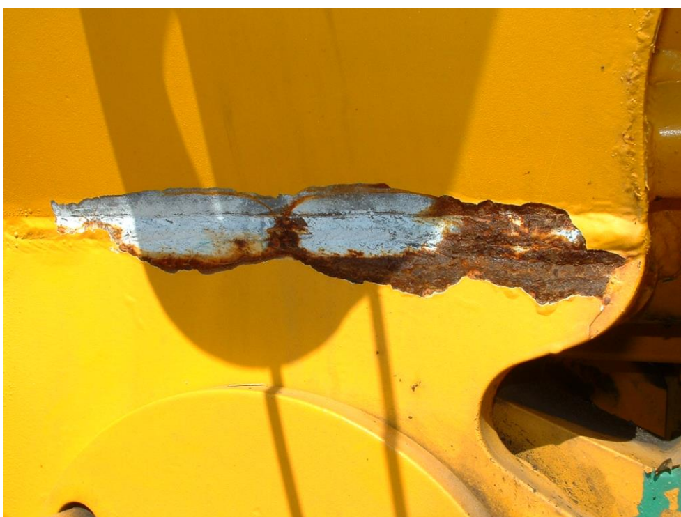
Hibahely feltárás acéllemez szerkezetnél 1.
