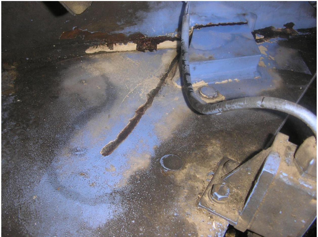
A feltárt repedések a koszorú lekötés körül a forgóasztalon
