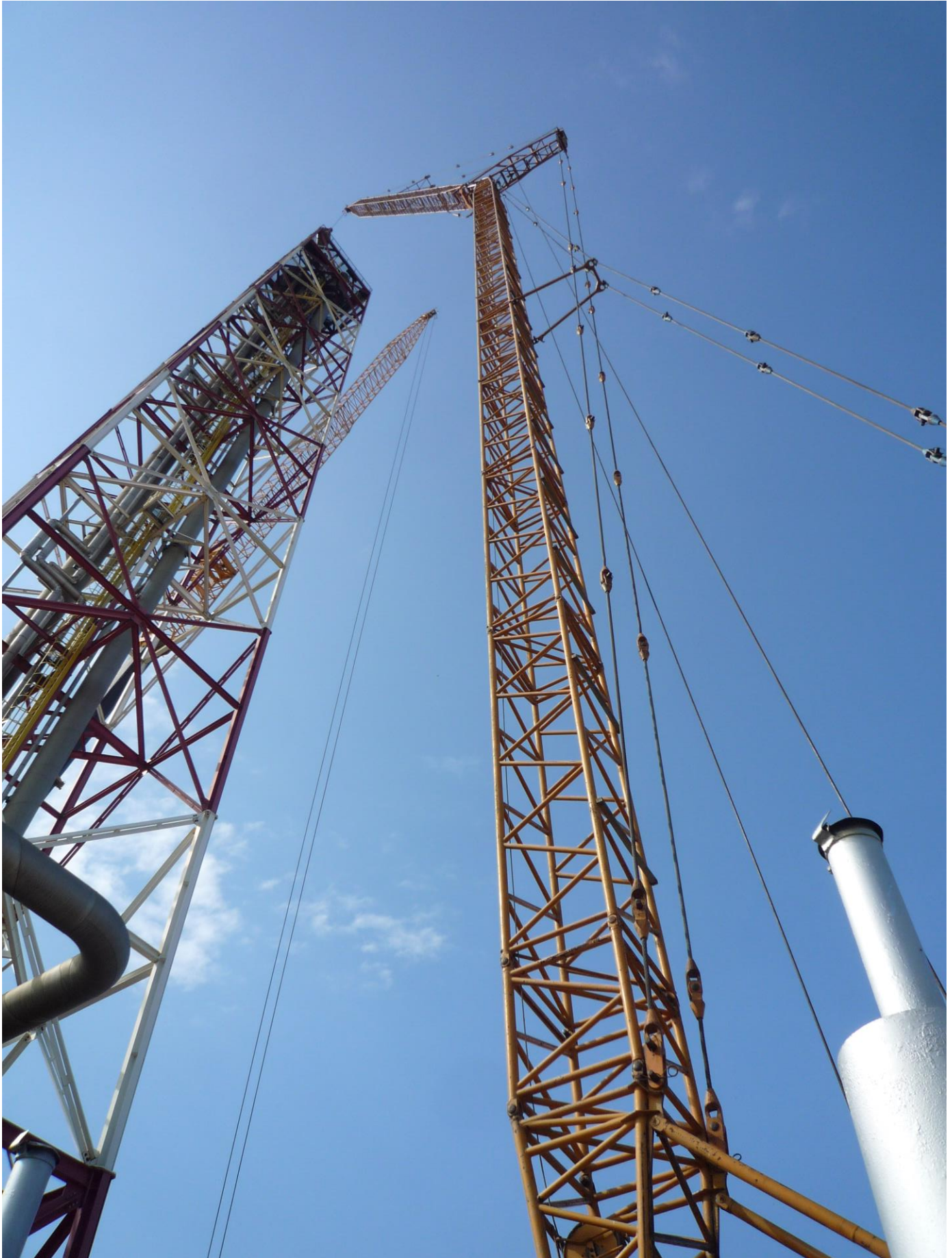
Kép az acélrács szerkezetek szemrevételezéses vizsgálatához 1. – az azonos állásból a sérült rúd „kiugrik, Az övrúd eltekeredések láthatóvá válnak.
